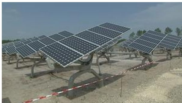
La centrale photovoltaïque du Gabardan. France 3
